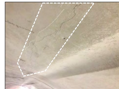
写真③:ひび割れ発生状況
