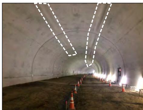
写真①:トンネル覆エコンクリートの凹み状況
