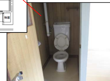
トイレは窓がなく閉塞感が漂う空間 換気設備がないため、衛生的に劣る
