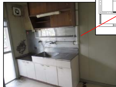
狭隘な台所 給排水管は更新時期を経過している
