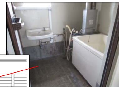
浴室には洗面台と風呂釜 があり狭隘 建替え後は手すりを設置 するなど高齢者に配慮した 浴室となる
